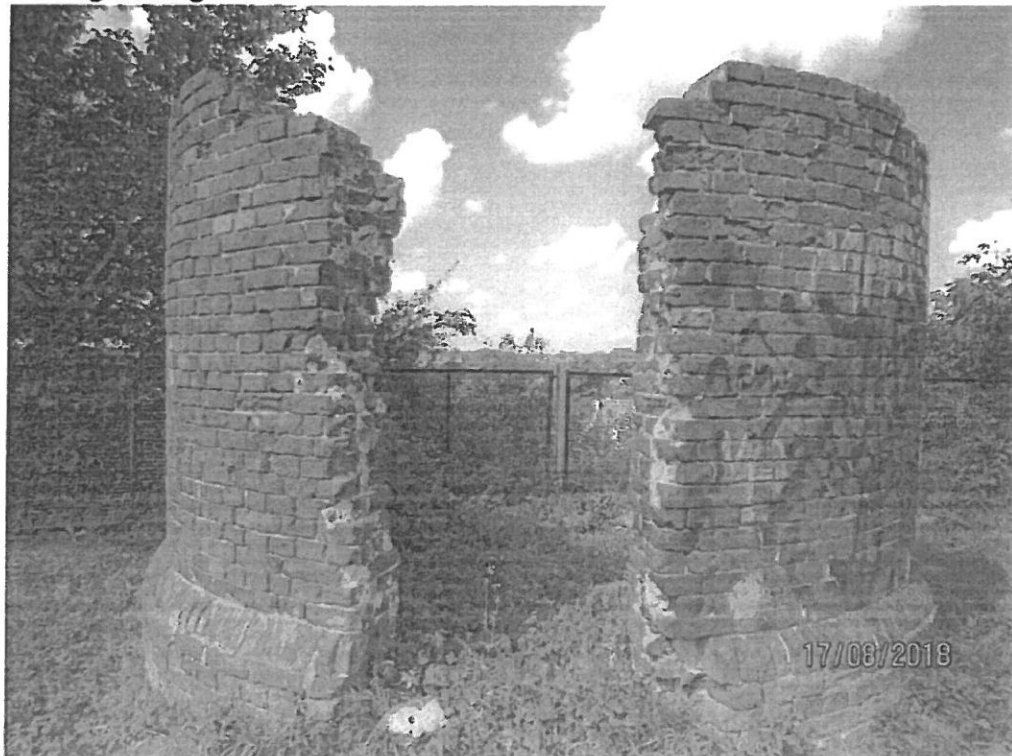
2. Nierówne strzępia ubytku.
