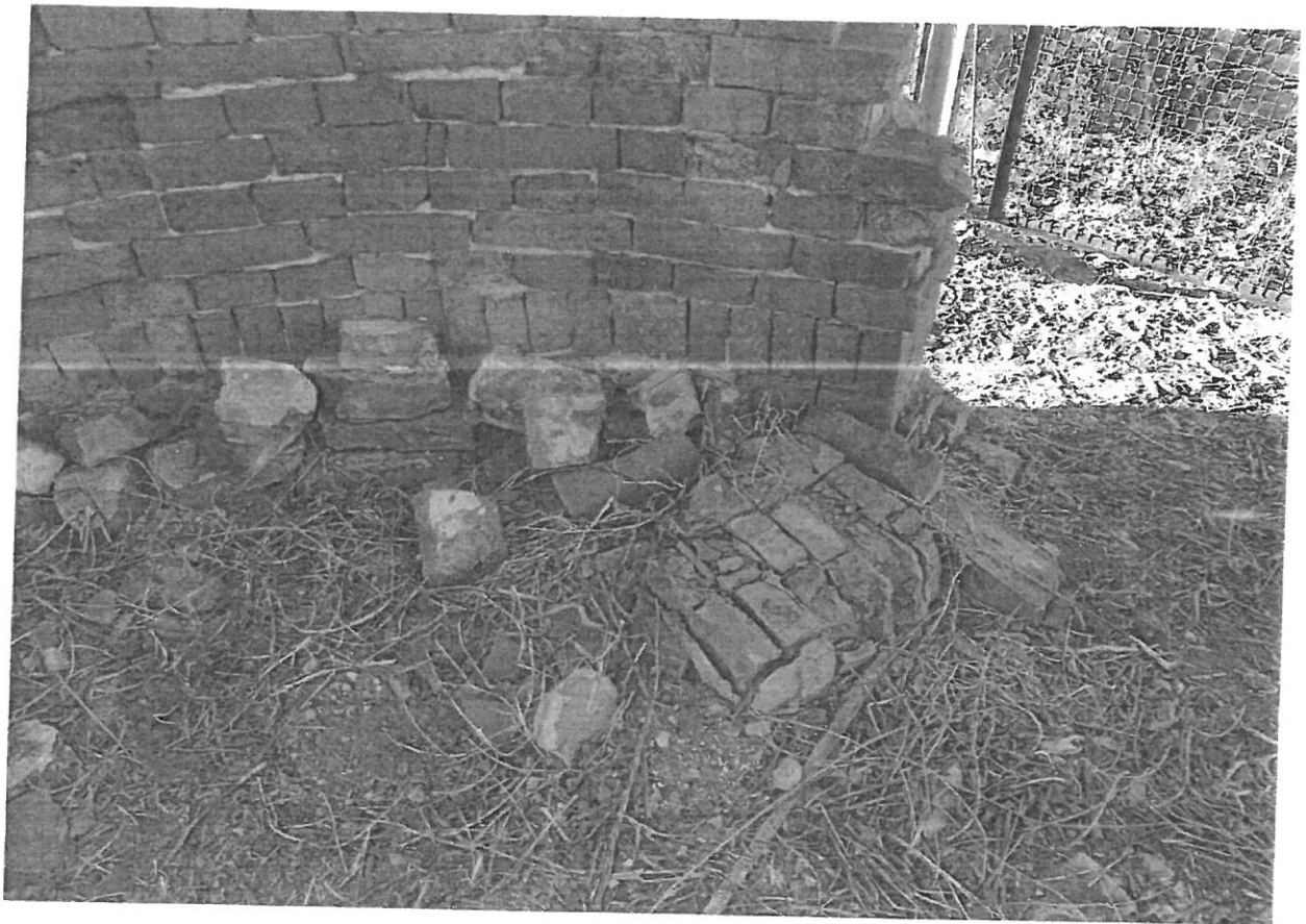
Luźne cegły, uszkodzony fragment muru i rumosz.
