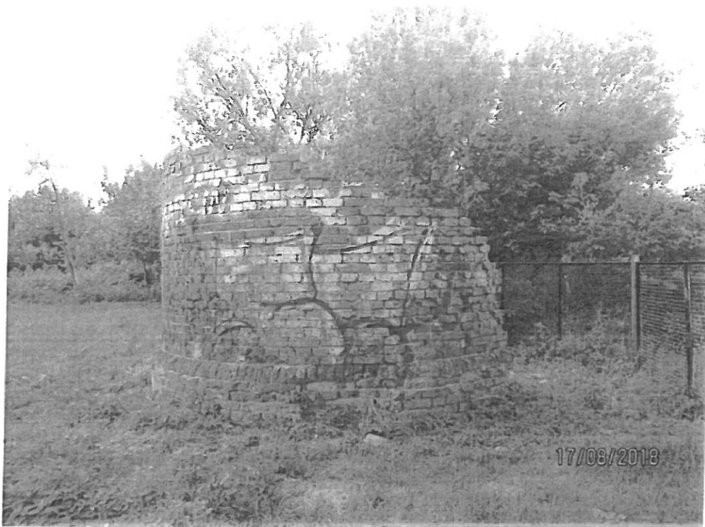
3. Graffiti pokrywające cegły.
